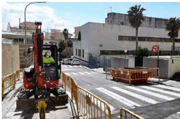
Canalización de gas de la obra. / EPDA
