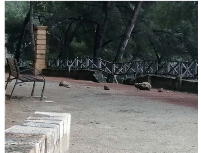
El desprendimiento afectó a la valla y al petril. / EPDA
