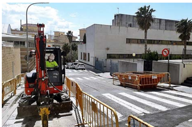
Canalización de gas de la obra. / EPDA
