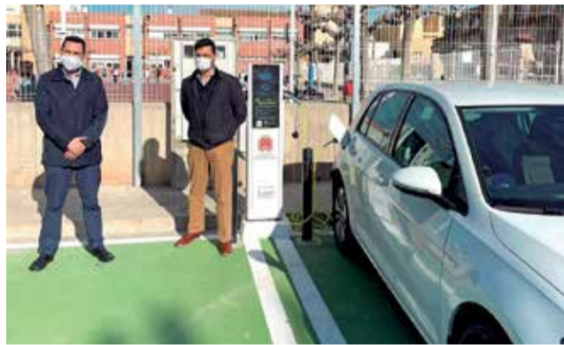
El alcalde en uno de los puntos de recarga. / EPDA
