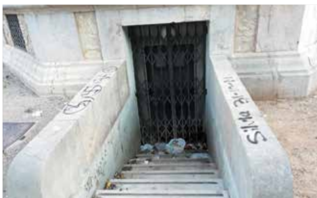
Suciedad en la escalera de entrada a la pérgola. /H. G.
