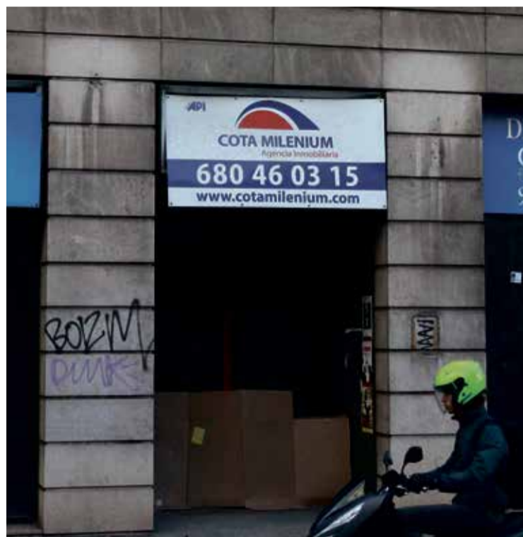
Deterioro en un local cerrado. / D. NAVARRO
