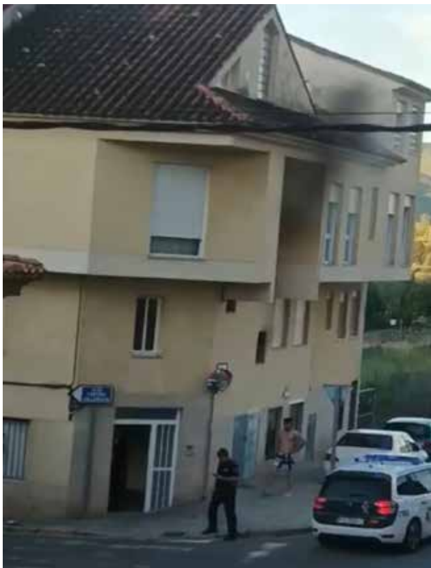
Casa afectada por el fuego / EPDA
