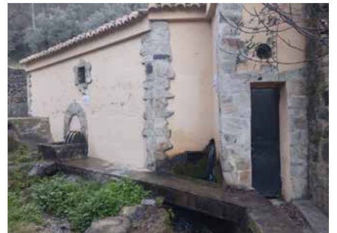
La actuación mejorará la seguridad sanitaria. / EPDA
