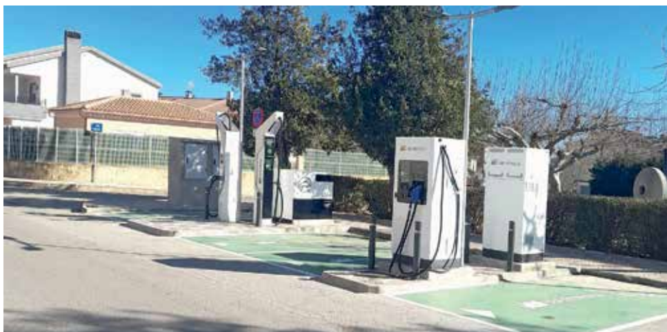
Estación de recarga. / EPDA
