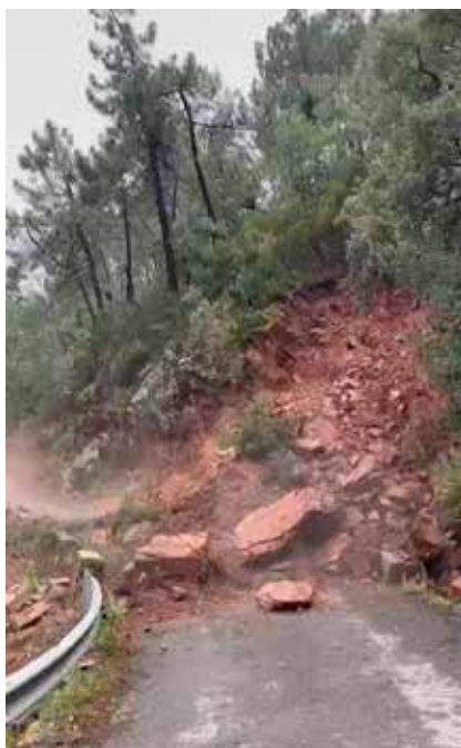
Desprendimiento en CV-200 / EPDA
