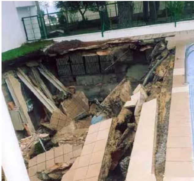
Colapsó el forjado y se hundió. / EPDA
