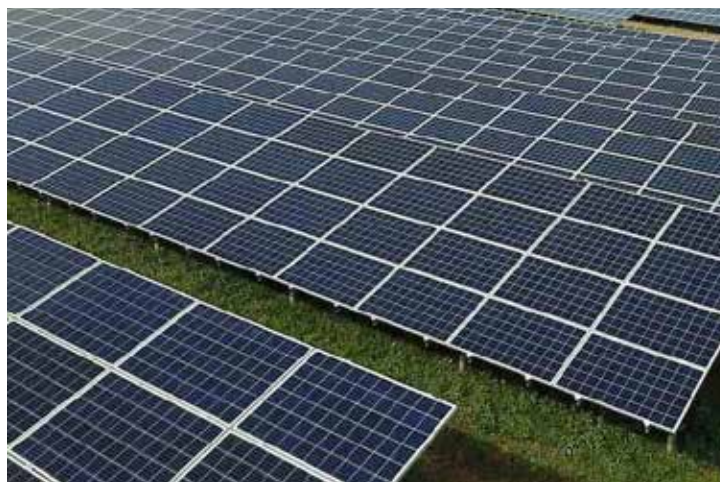
Parque solar. / EPDA
