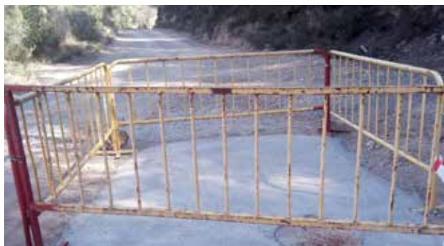
El paso de un camión de bomberos lo hundió. / EPDA
