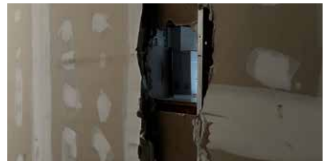
Diferentes daños en la oficina / J.GINÉS
