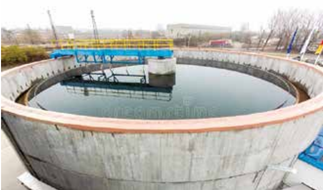
Depuradora de tratamiento de aguas. / ARCHIVO
