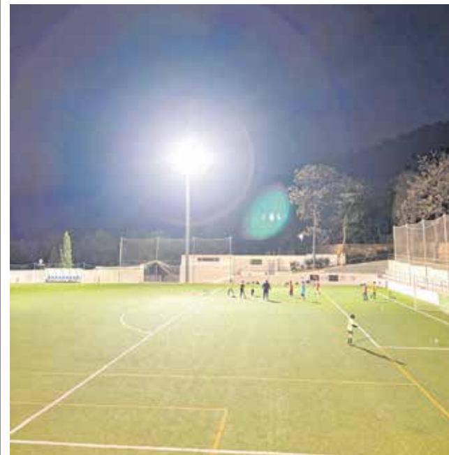
El camp amb la nova il·luminació. / EPDA
