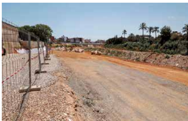
Un tramo del camino dañado por la dana. / EPDA
