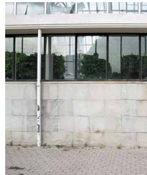
El edificio no presenta un buen estado. /
