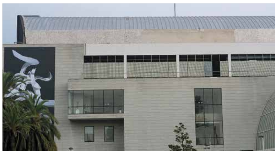
Fachada lateral del icónico edificio con los desperfectos a la vista. / EPDA
