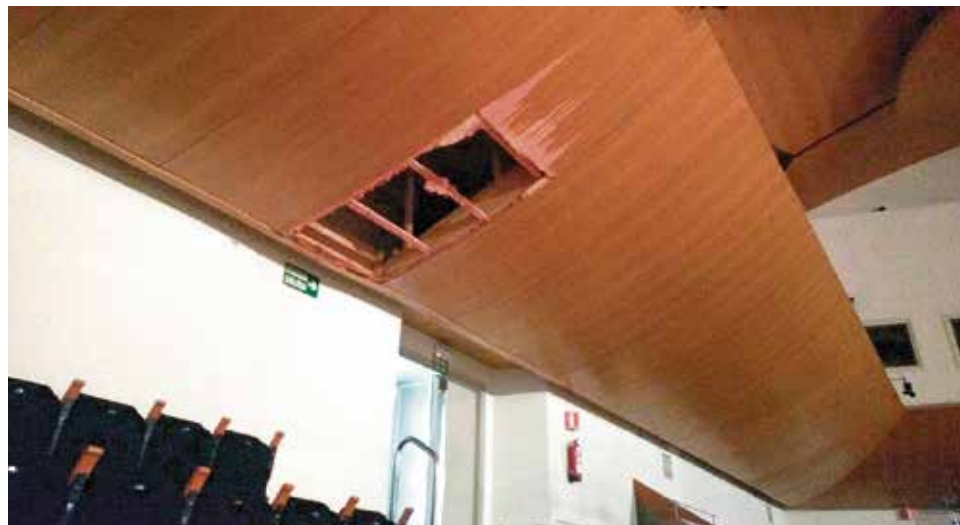
Un concha acústica cayó en noviembre de 2018 en la sala Iturbi. / AJUNTAMENT DE VALÈNCIA
