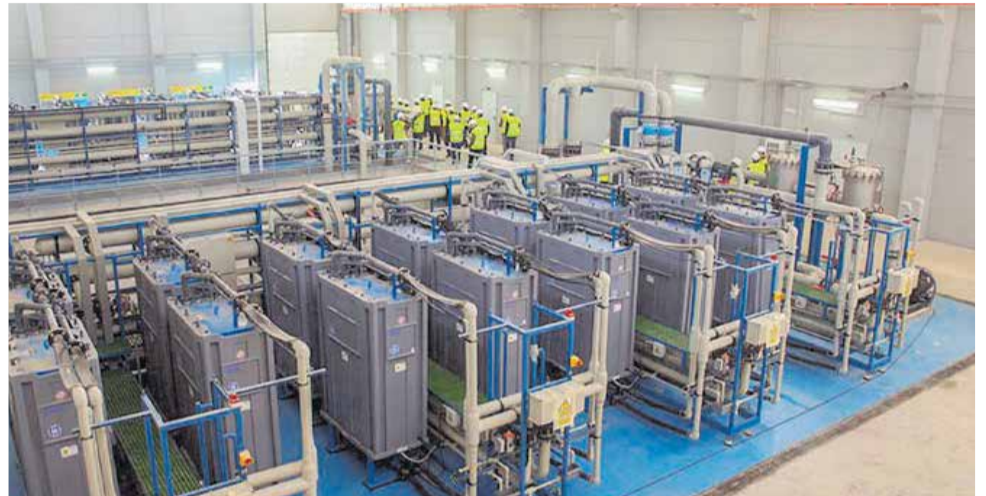
Vista general de la planta desnitricadora. / EPDA
