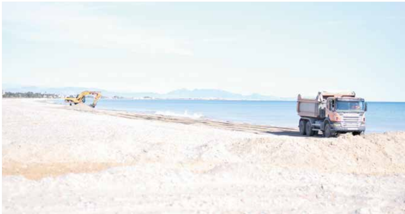
Máquinas retirando grava en la playa de la Almardà, al norte de Sagunt. / EPDA
