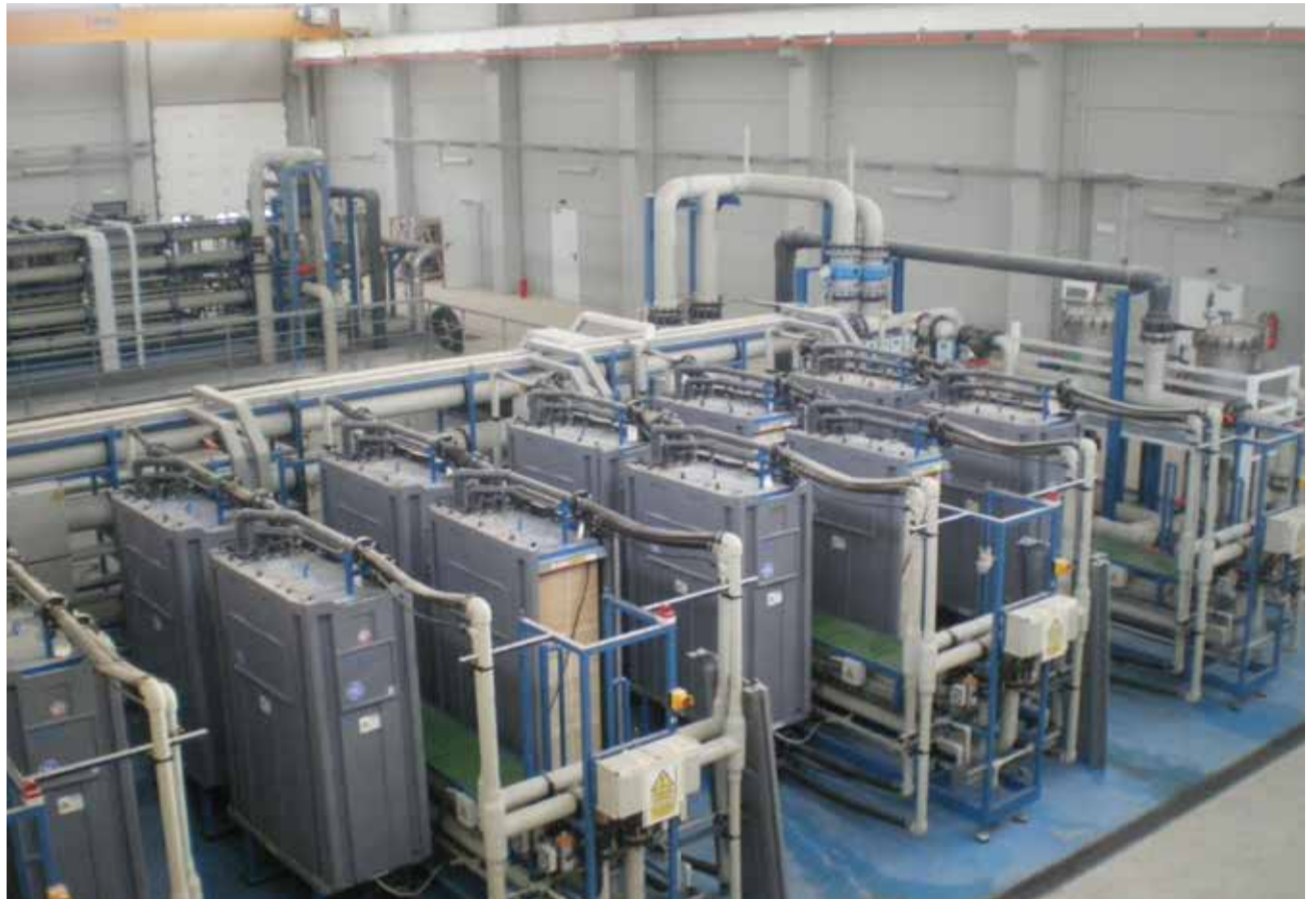
La planta desnitrificadora ha entrado en funcionamiento en pruebas bajo la gestión de Hidraqua. / EPDA
