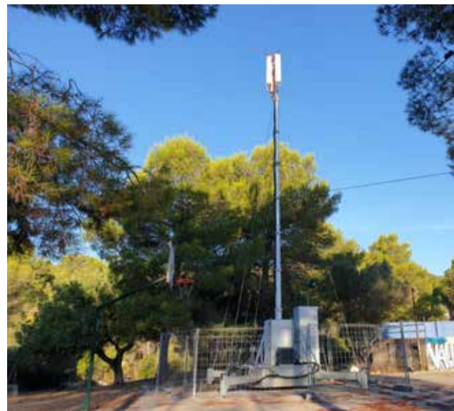
Antena temporal instalada en Santo Espíritu / EPDA
