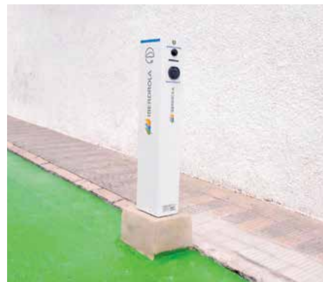
Punto de recarga para vehículos eléctricos. / EPDA
