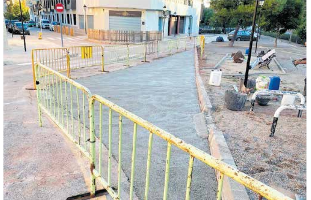
Detalle de las obras que se están desarrollando en la calle. / EPDA
