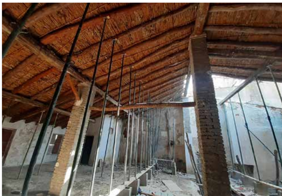
Edificio de la antigua posada, en estado de ruina. / EPDA
