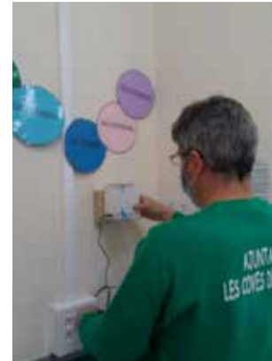
Instalación en el CEIP/EPDA
