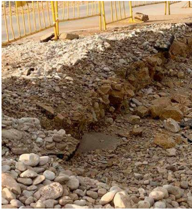
Daños en la costa de Alcalà-Alcossebre / EPDA
