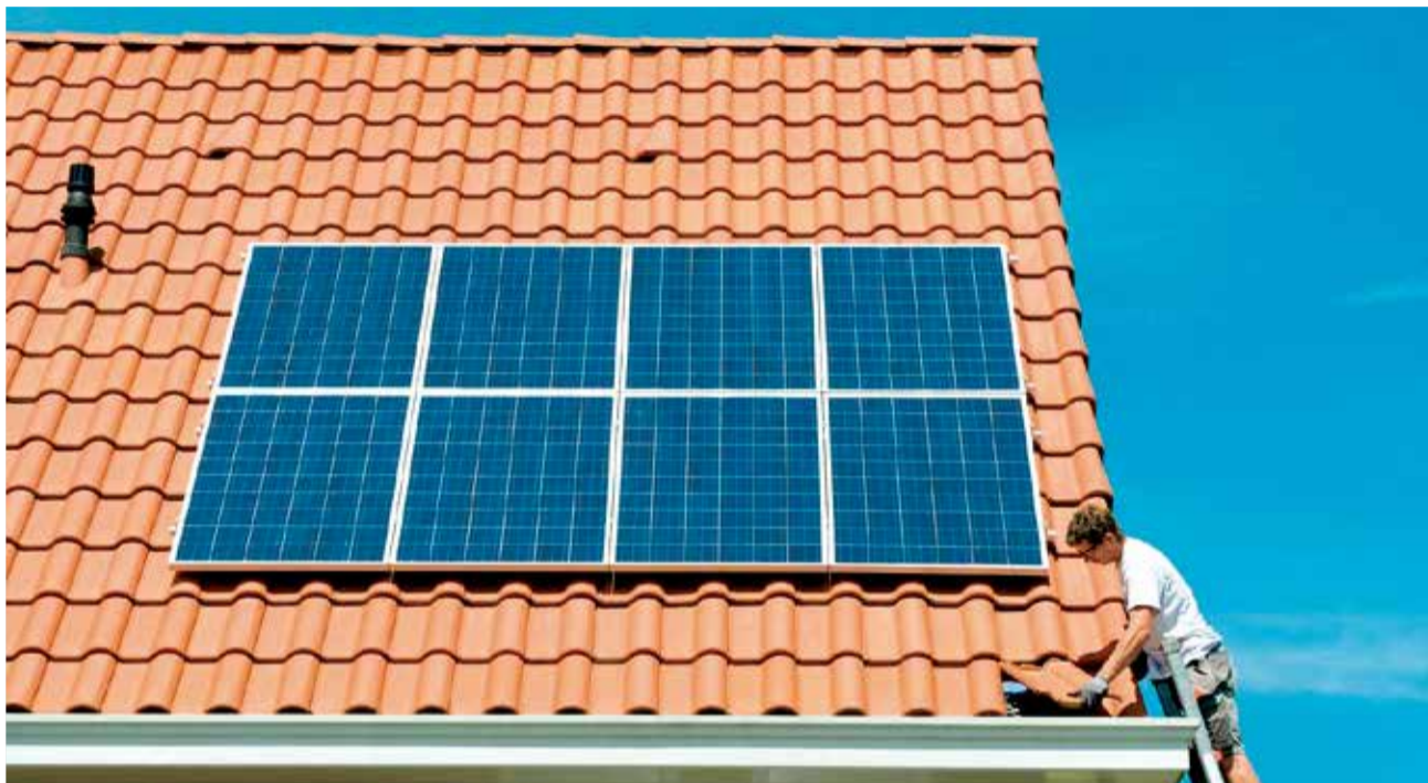
Plaques fotovoltaïques. / EPDA
