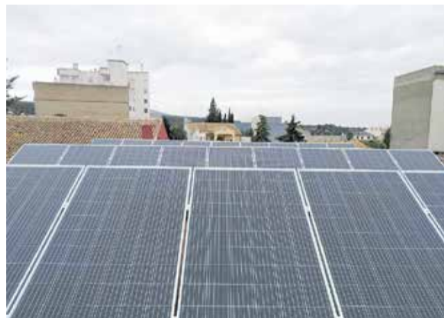
Placas fotovoltaicas instaladas en Yátova. / EPDA
