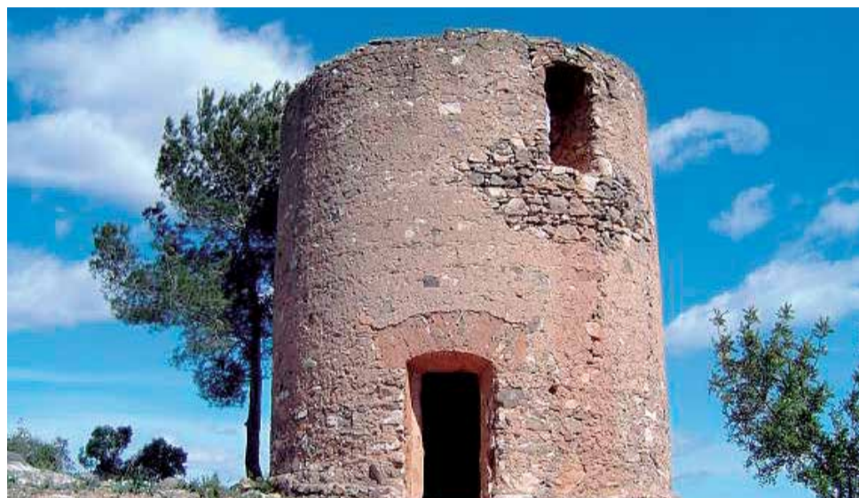
Molí de Vent de Quart de les Valls, un dels símbols del municipi. / EPDA
