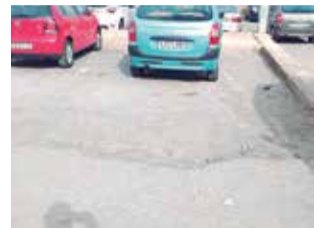
Estado del asfalto. / EPDA
