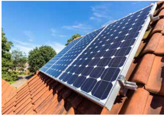
Una de les plaques solars instal·lades. / EPDA
