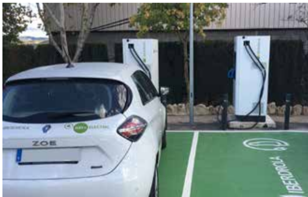
Vehículo eléctrico. / EPDA
