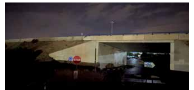
Rotonda afectada. / EPDA
