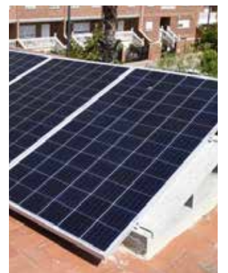
Paneles solares. / EPDA
