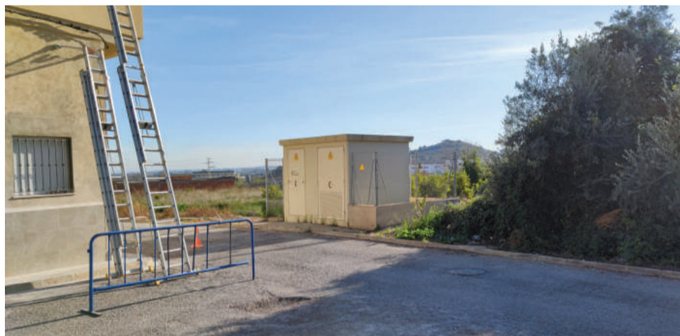
Centre de Transformació de Vilamarxant. / EPDA
