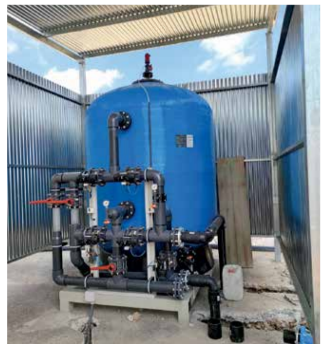
Potabilitzadora instal·lada a Senyera. / EPDA
