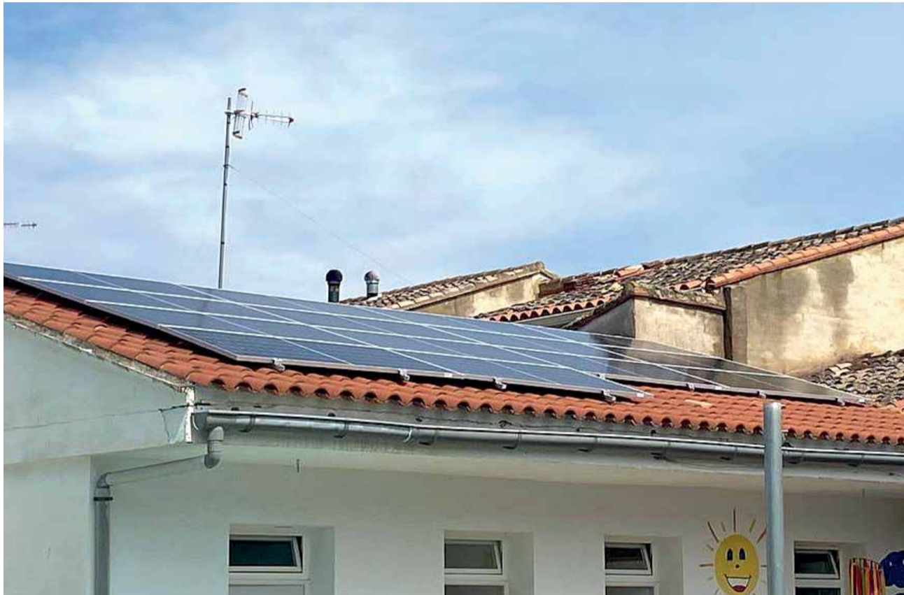
Plaques solars fotovoltaïques al centre escolar de Sellent. / EPDA
