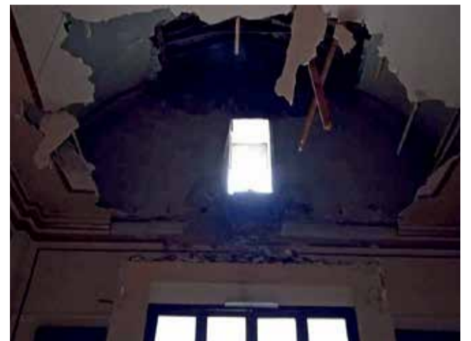
La ermita dañada. / EPDA
