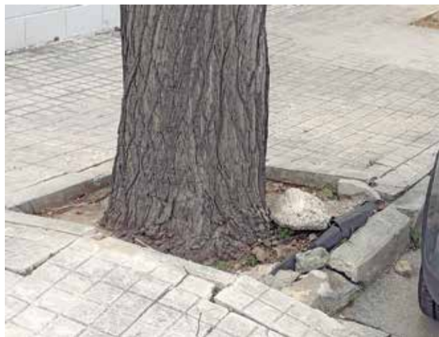
Alcorque en mal estado en Sedaví. / EPDA
