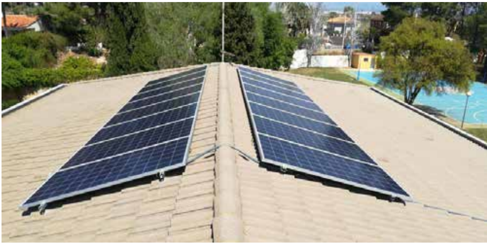
Una de les plaques instal·lades al municipi. / EPDA
