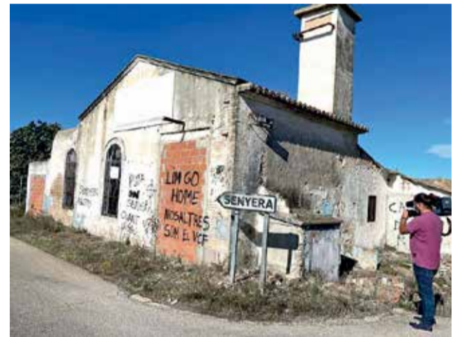
Caseta abandonada de Senyera. / EPDA
