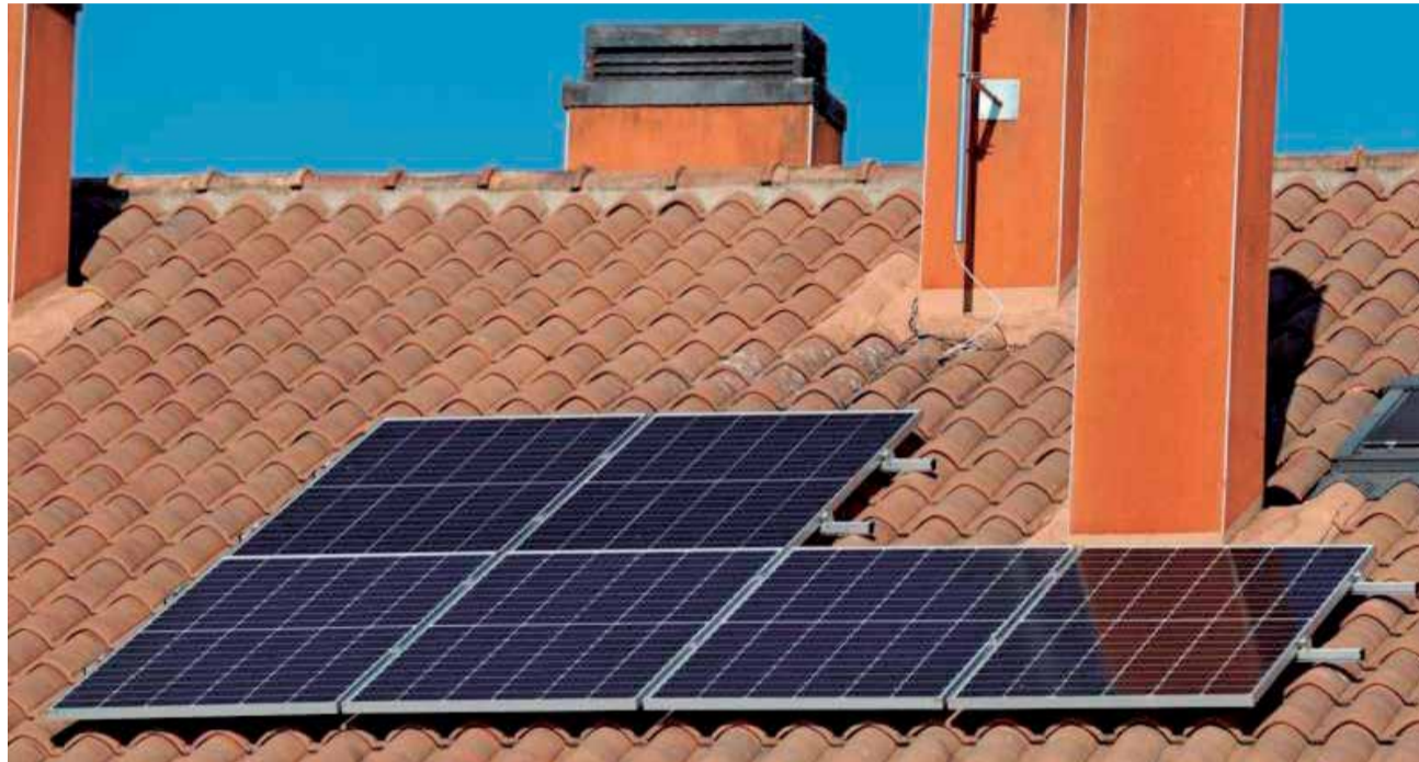
Placas solares instaladas en una vivienda de Port de Sagunt. / EFE
