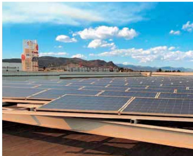
Techo de VidaNova Parc con las placas. / EPDA
