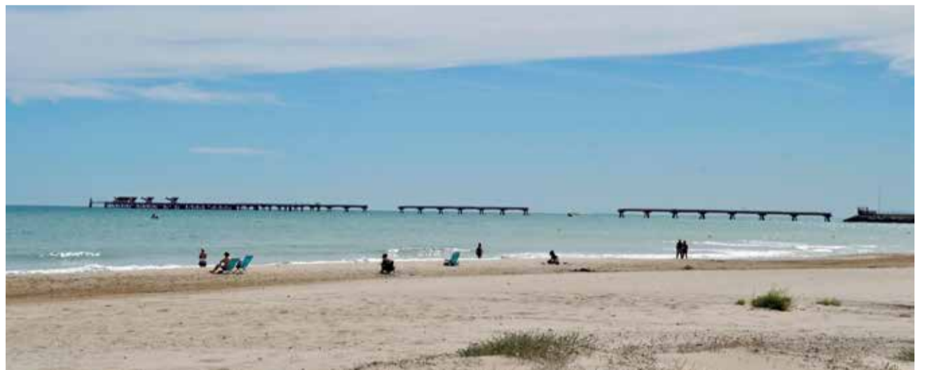
Vista completa del estado actual del Pantalán de Port de Sagunt: se observan las tres roturas. / MINERVA G. G.
