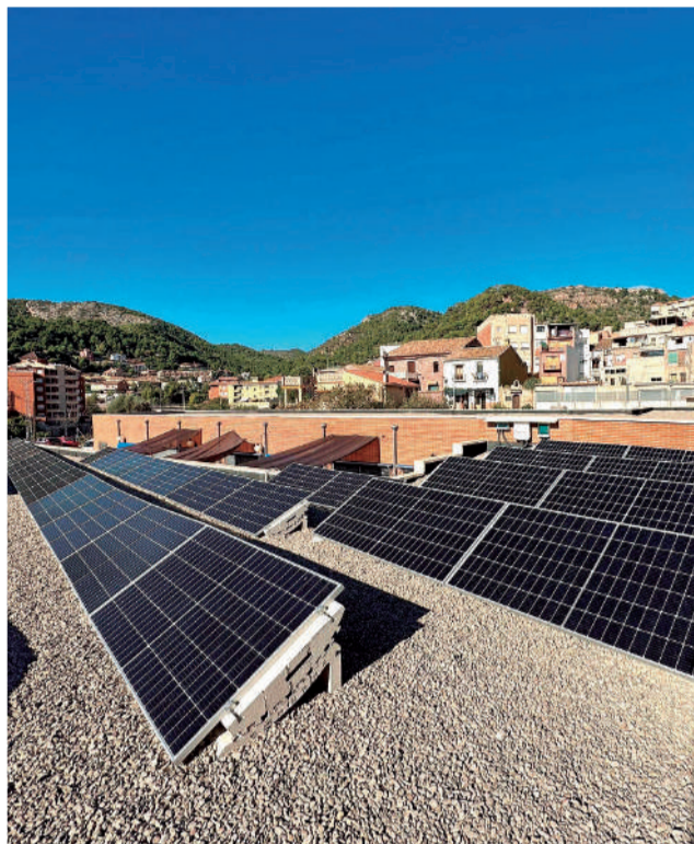
Placas solares del CEIP Sant Josep de Serra. / EPDA
