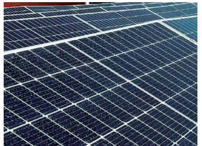
Placas solares fotovoltaicas de Benagéber. / EPDA
