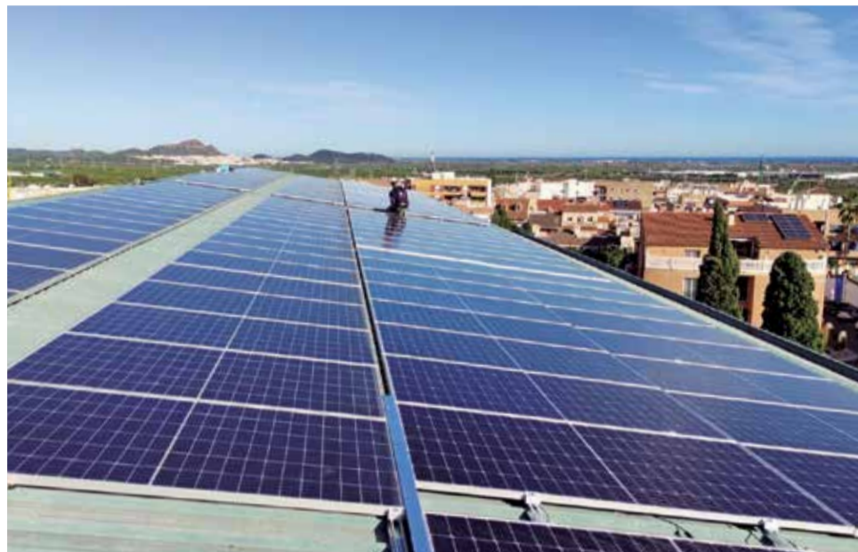
Ampliación de la comunidad energética local de Faura. / EPDA
