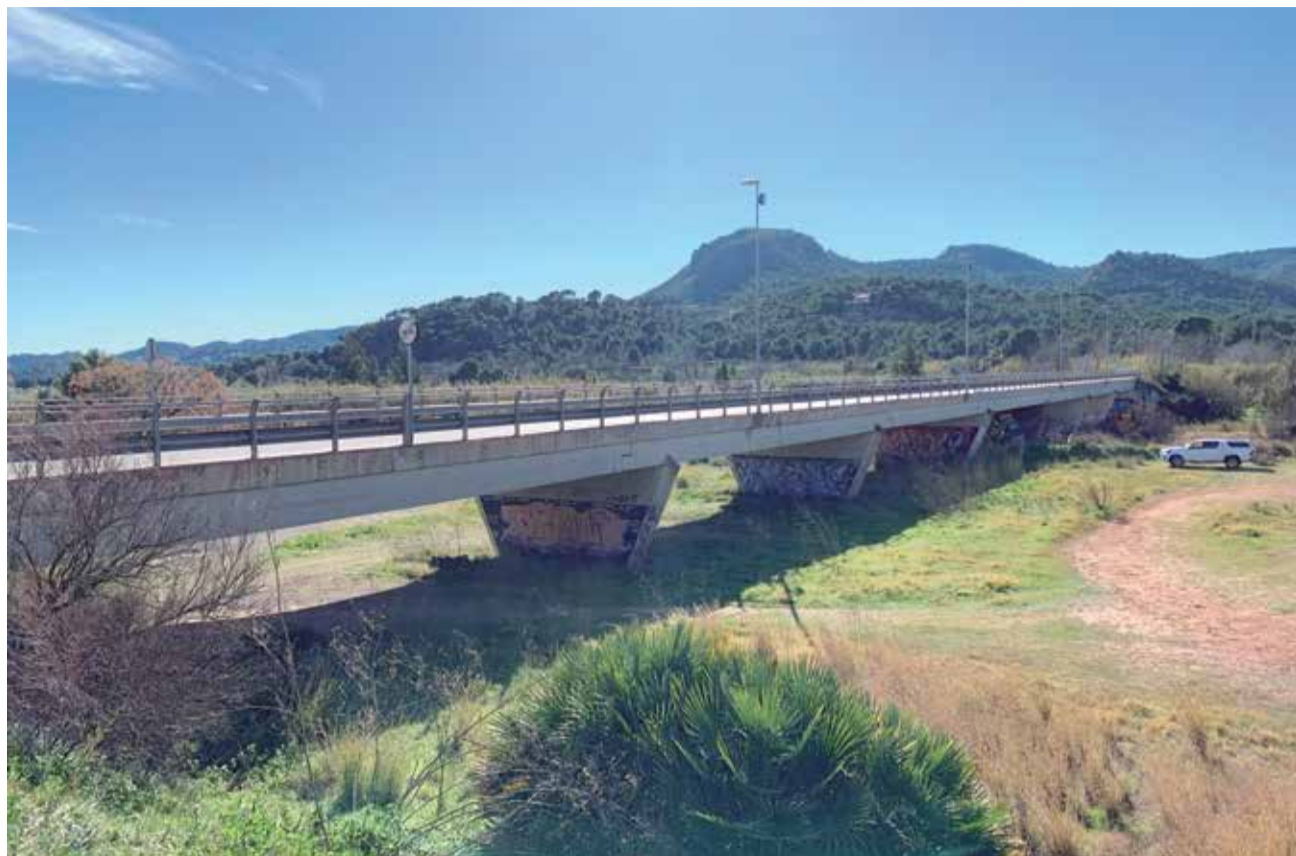
Vista de un tramo del puente de Albalat dels Tarongers. / BORJA PEDRÓS
