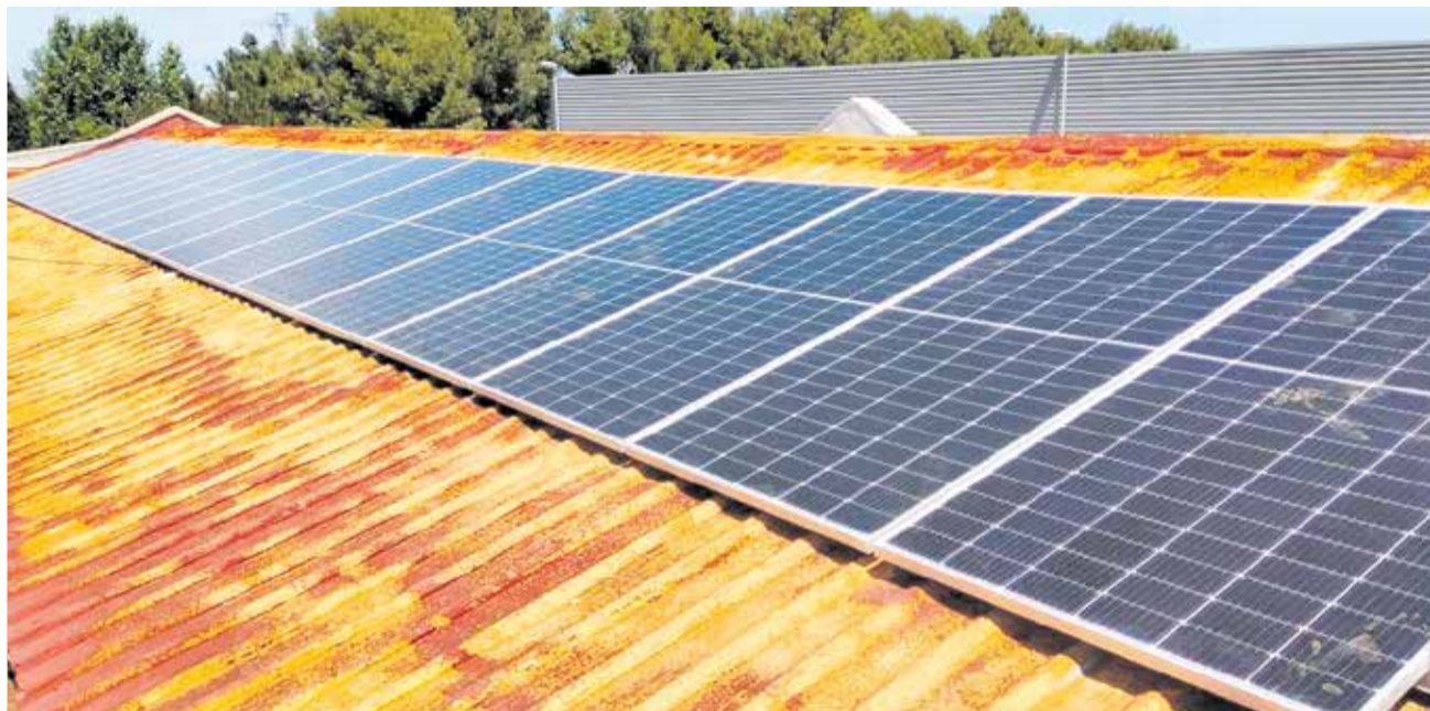
Plaques instal·lades al poliesportiu de l'Alqueria de la Comtessa. / EPDA
