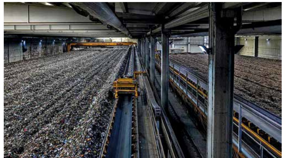
Noves millores en el complex de valorització de residus de Guadassuar. / EPDA
