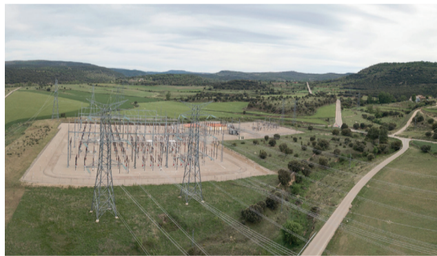
Subestació a la localitat de Morella. / EPDA
