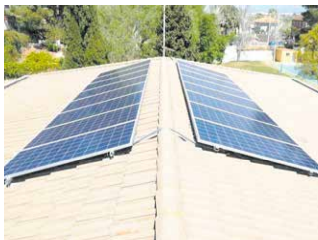
Placas solares en un edificio de Riba-roja. / EPDA
