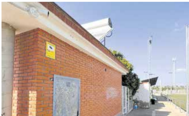
Càmeres instal·lades en el poliesportiu. / EPDA
