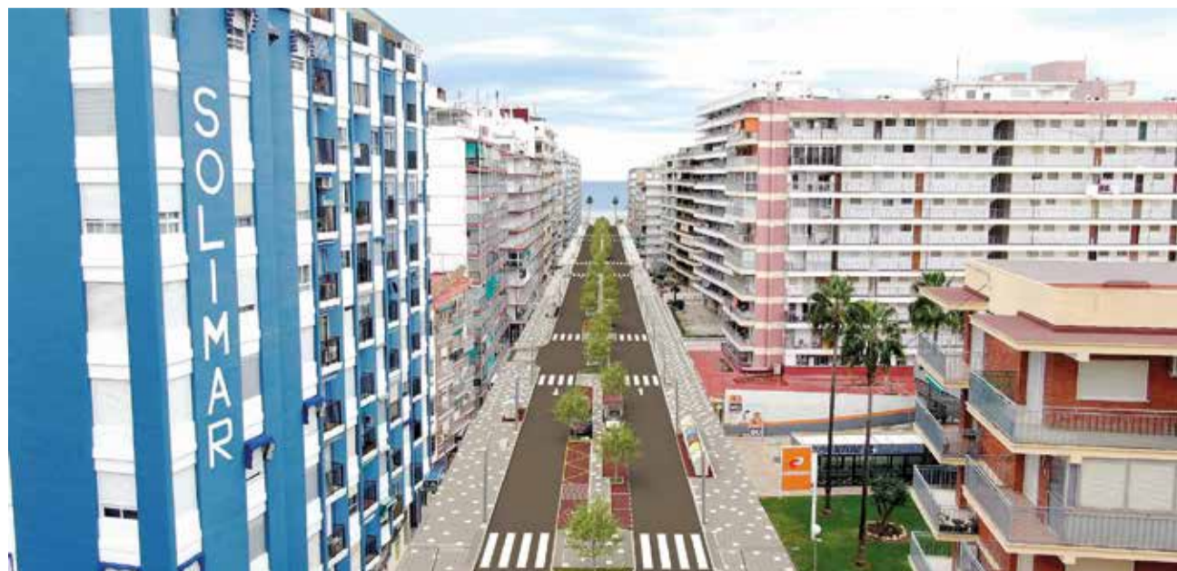
Les obres del carrer Caminàs de Cullera fins al passeig marítim. / EPDA
