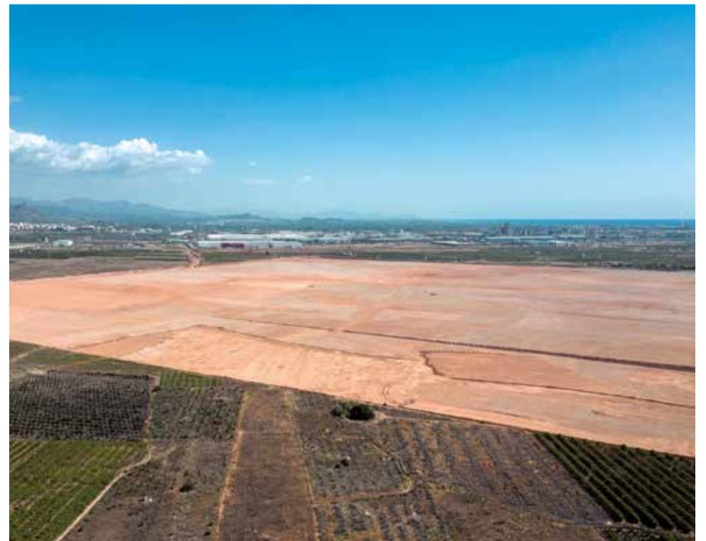
Vista aérea de las obras donde se situará la gigafactoría de celdas. / BIELALIÑO (EFE)
